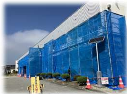
校舎軒下の工事を行っています。校章も磨いて掲げられる予定です。
